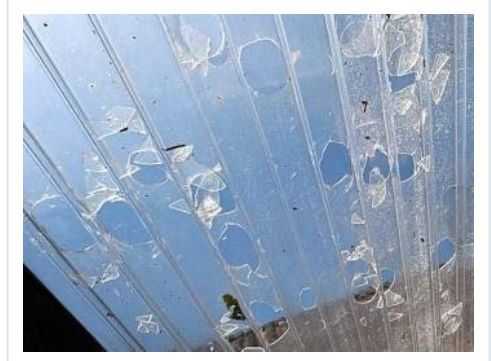
Hagelschaden an einer ungeschützten Verglasung
