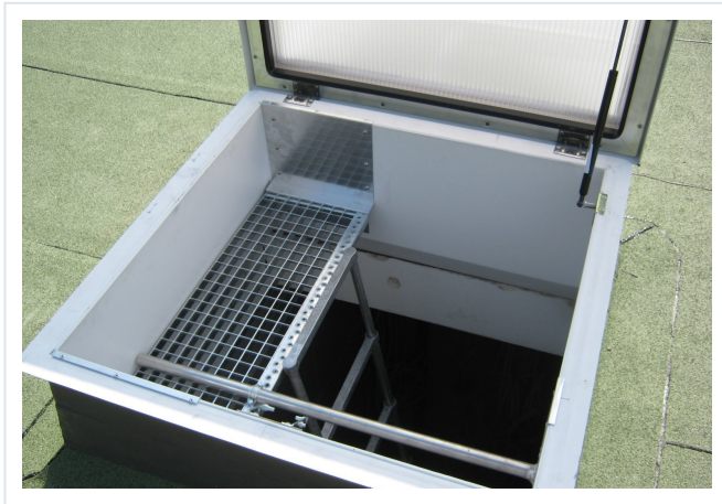
Dachausstieg mit Durchsturzgitter, geöffnet
