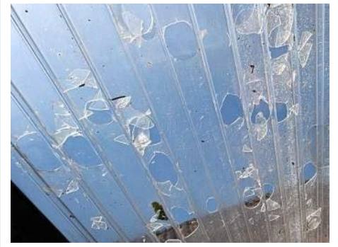
Hagelschaden an einer ungeschützten Verglasung
